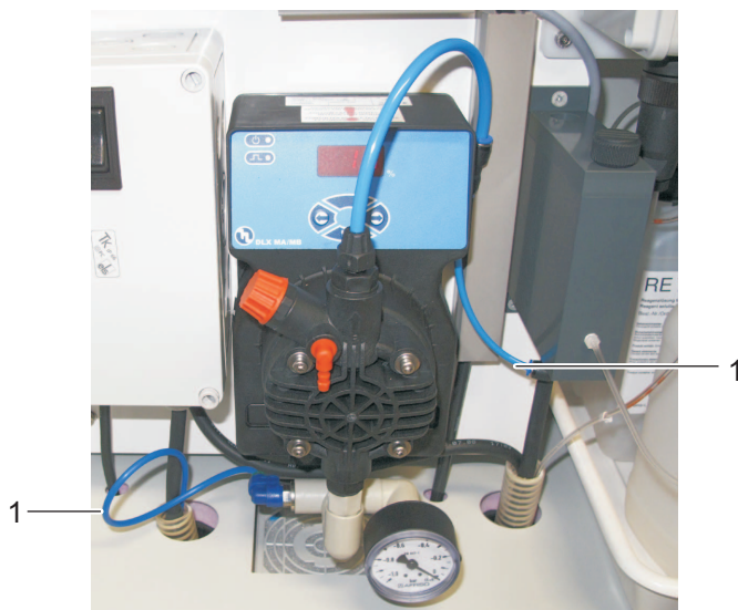
Abb. 5-23: Filtrationspumpe mit Saugschlauch
